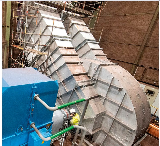
New sinter gas fan (© Howden Turbowerke GmbH)
